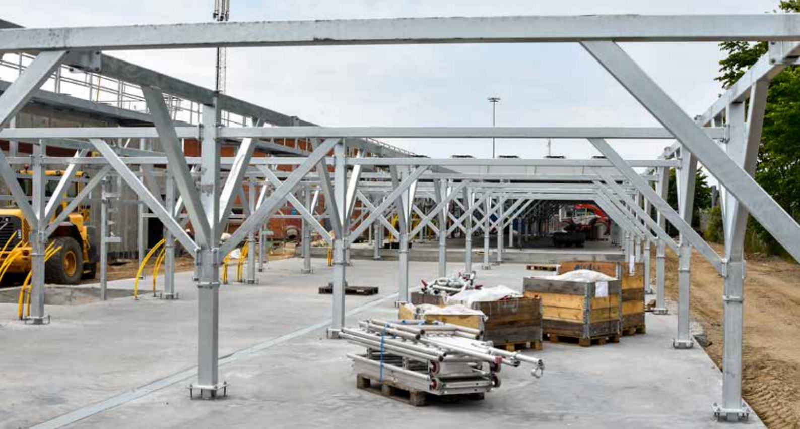
På et 800 m2 stort område står fordamperanlægget, der trækker udeluft ned gennem sine mange finner og trækker varmen ud af den, før varmen ender hos forbrugerne
